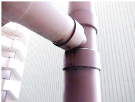
水漏れの跡が くっきりと残っています
